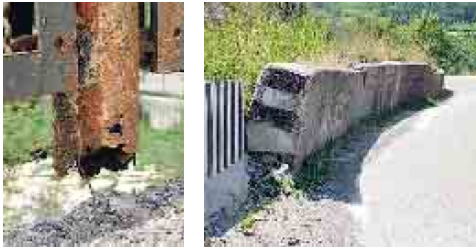
Il ponte arrugginito a Perino e il muretto a Ronco dell'Oste (foto Zangrandi)
